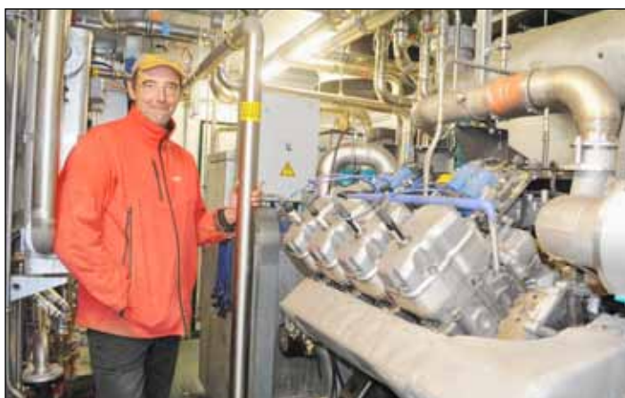
Jean-Pierre Sauvageot à côté de l'impressionnant V8 qui produit électricité et chaleur.
